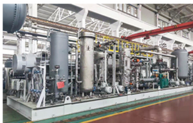
CO 2 捕集、驱油与埋存技术示范 工程配套装置
