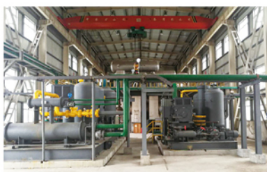
低温甲醇洗 10 万吨 CO 2 项目增 压液化装置
