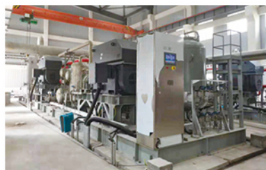
15 万吨 / 年电厂烟气 CO 2 捕集 示范工程增压液化装置
