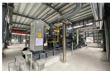
10 万吨合成氨尾气综合利用项 目螺杆二氧化碳压缩机
