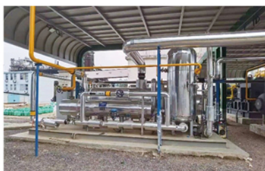
5 万吨 / 年 CO 2 捕集试验区项目 增压液化装置
