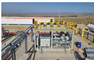
CO 2 驱综合试验站增压液化装置
