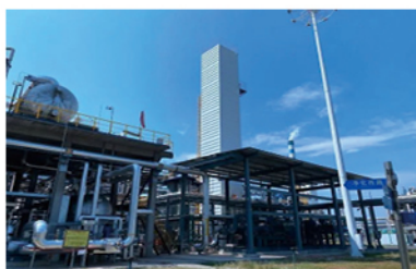
低温甲醇洗排放尾气回收年产 8 万 吨 CO 2 项目增压液化装置
